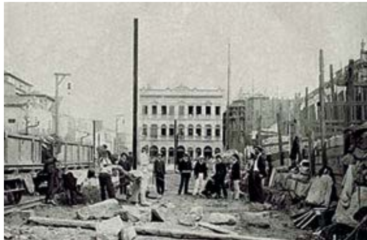
Figura 10.3: Demolições para a construção da avenida Central, 1904-1905. João Martins Torres - Acervo Instituto Moreira Salles
