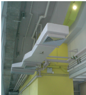
Figura 15.1: Equipamento de Ar Condicionado.
